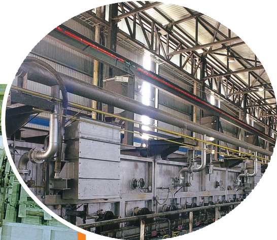
Soaking furnace to ensure even slab temperature. Relau rendaman untuk memastikan suhu 'slab' sekata.
